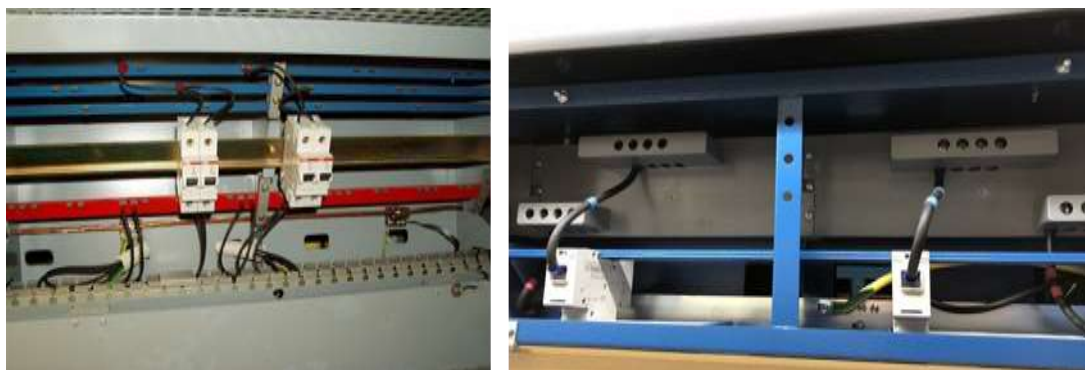
Figura 79 - Esempio di terminazione cavi unipolari su struttura di fila tipo ST81 (SX) e ST 2009 (DX)
