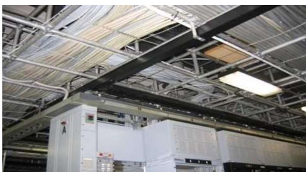
Figura 17 Canalina F.O. Interfila/Lungofila
