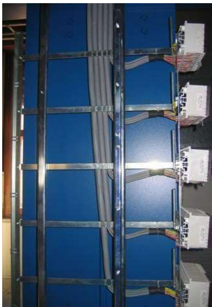
Figura 33 Discesa cavi su Ripartitore Doppio fronte
