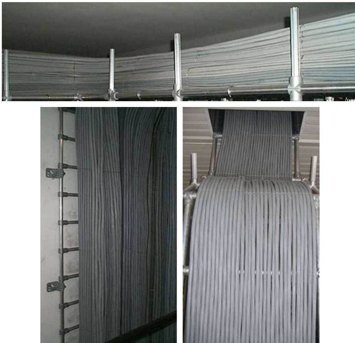
Figura 22 Esempio di posa orizzontale e verticale con pacco cavi omogeneo e compatto
