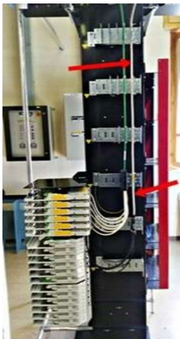
Figura 36 Discesa cavo Break-out su PO
