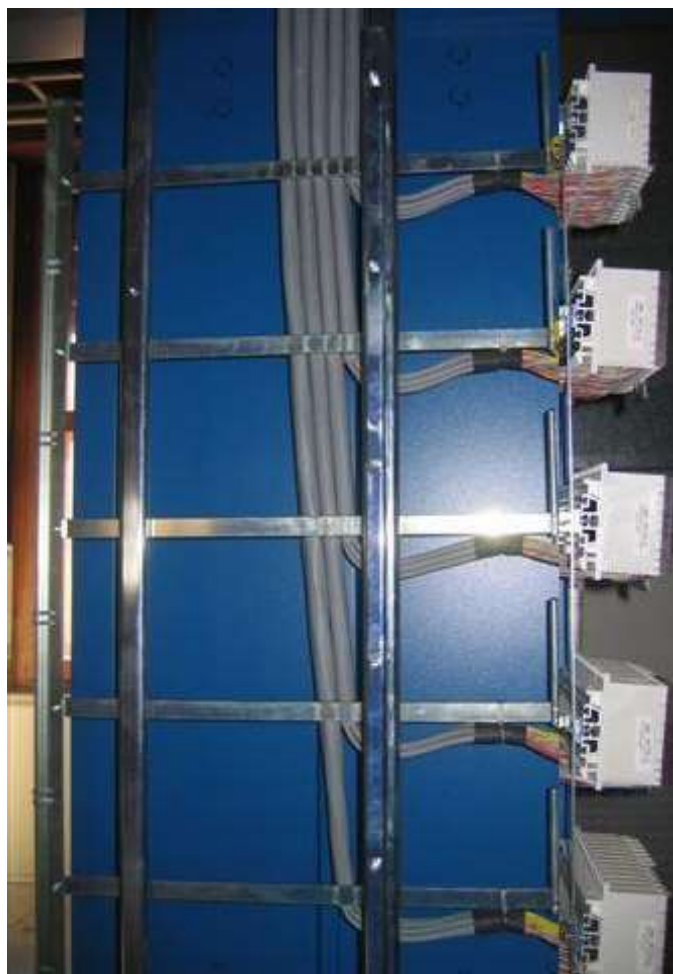
Figura 33 Discesa cavi su Ripartitore Doppio fronte
