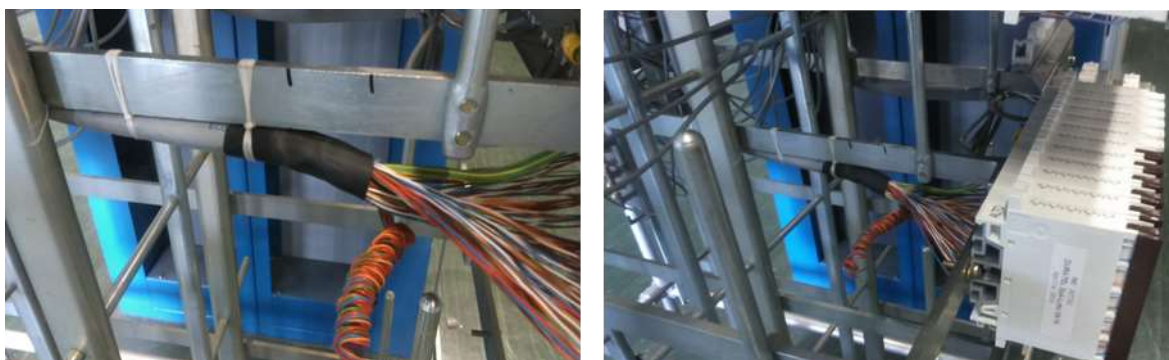
Figura 41 – Esempio di legatura dei cavi lato orizzontale del Rip DF in prossimità della striscia
