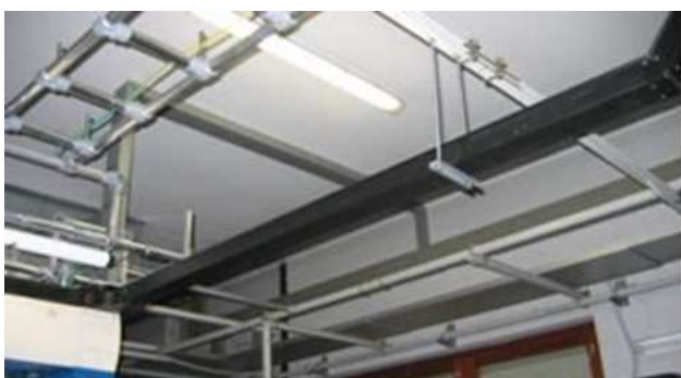
Figura 16 Canalina F.O. Interfila
