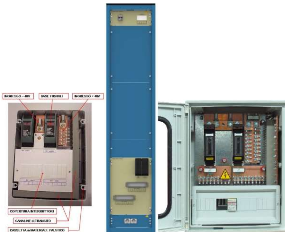
Figura 103 - Esempio di quadri esterni correntemente utilizzati (da sx: QDA da 160A; QDA con 3 sezioni da 250A (totale 750A; QDA da 400A)
