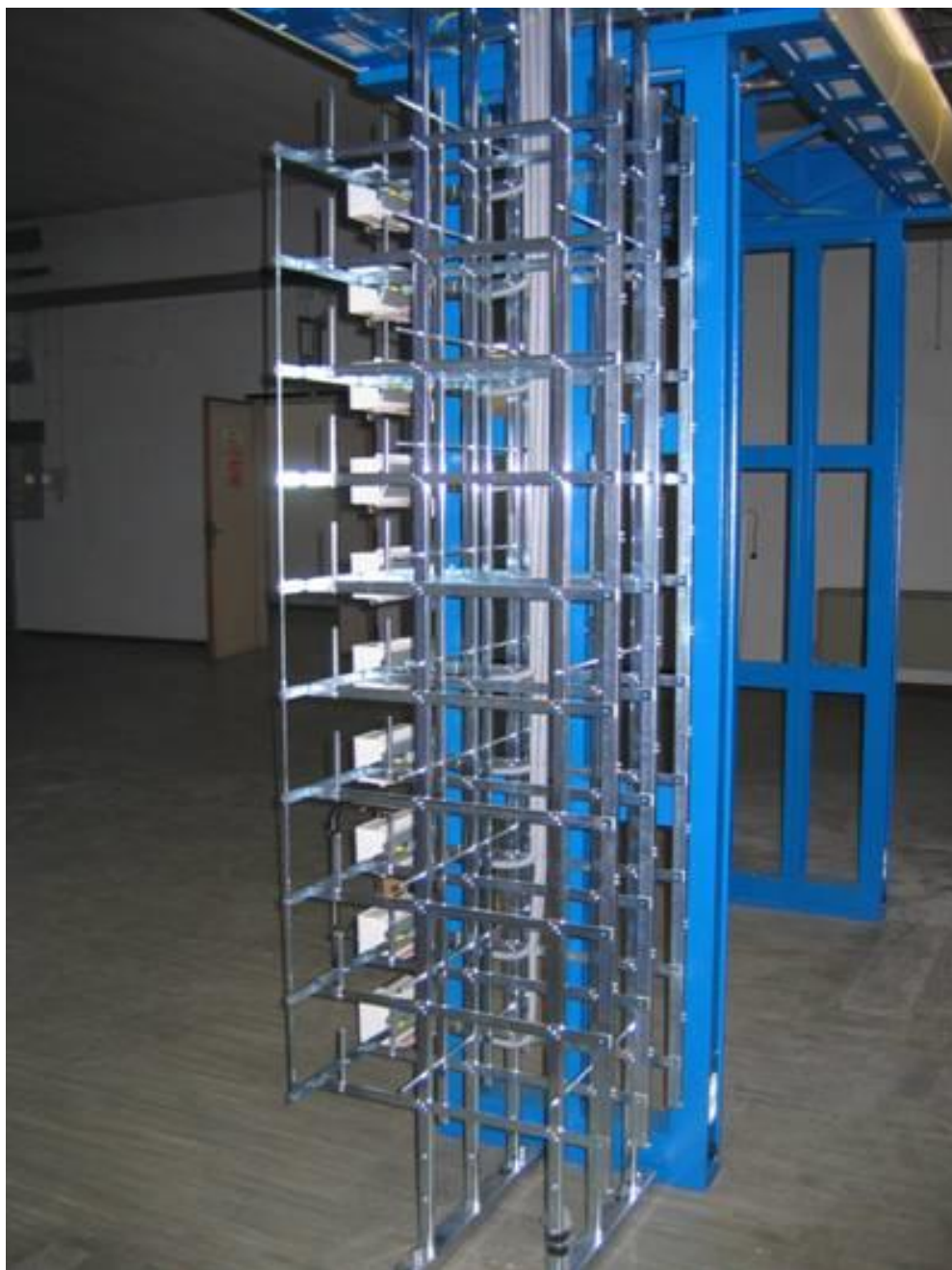
Figura 19: Ripartitore elettrico doppio fronte 10 livelli
