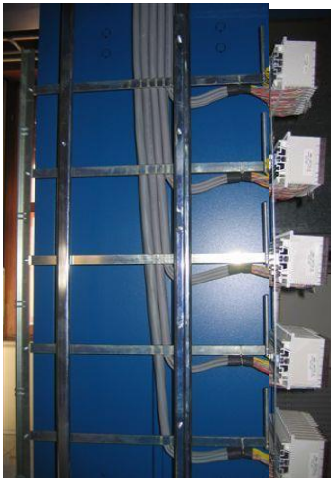
Figura 35: Discesa cavi su Ripartitore doppio fronte
