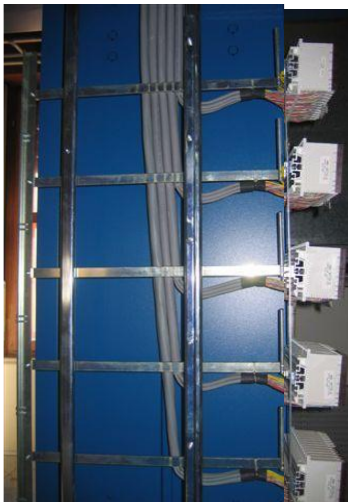
Figura 35: Discesa cavi su Ripartitore doppio fronte
