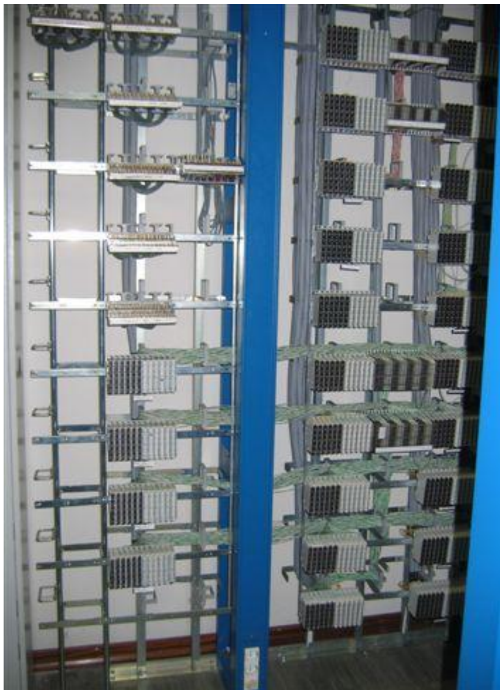
Figura 20: Ripartitore elettrico monofronte 10 livelli
