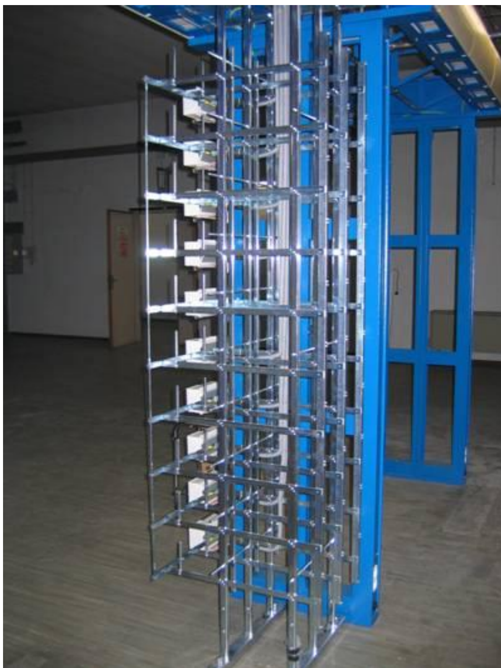
Figura 19: Ripartitore elettrico doppio fronte 10 livelli
