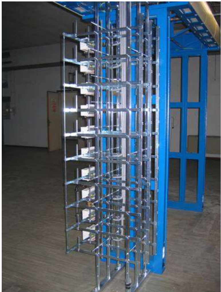
Figura 19 – Ripartitore elettrico doppio fronte 10 livelli
