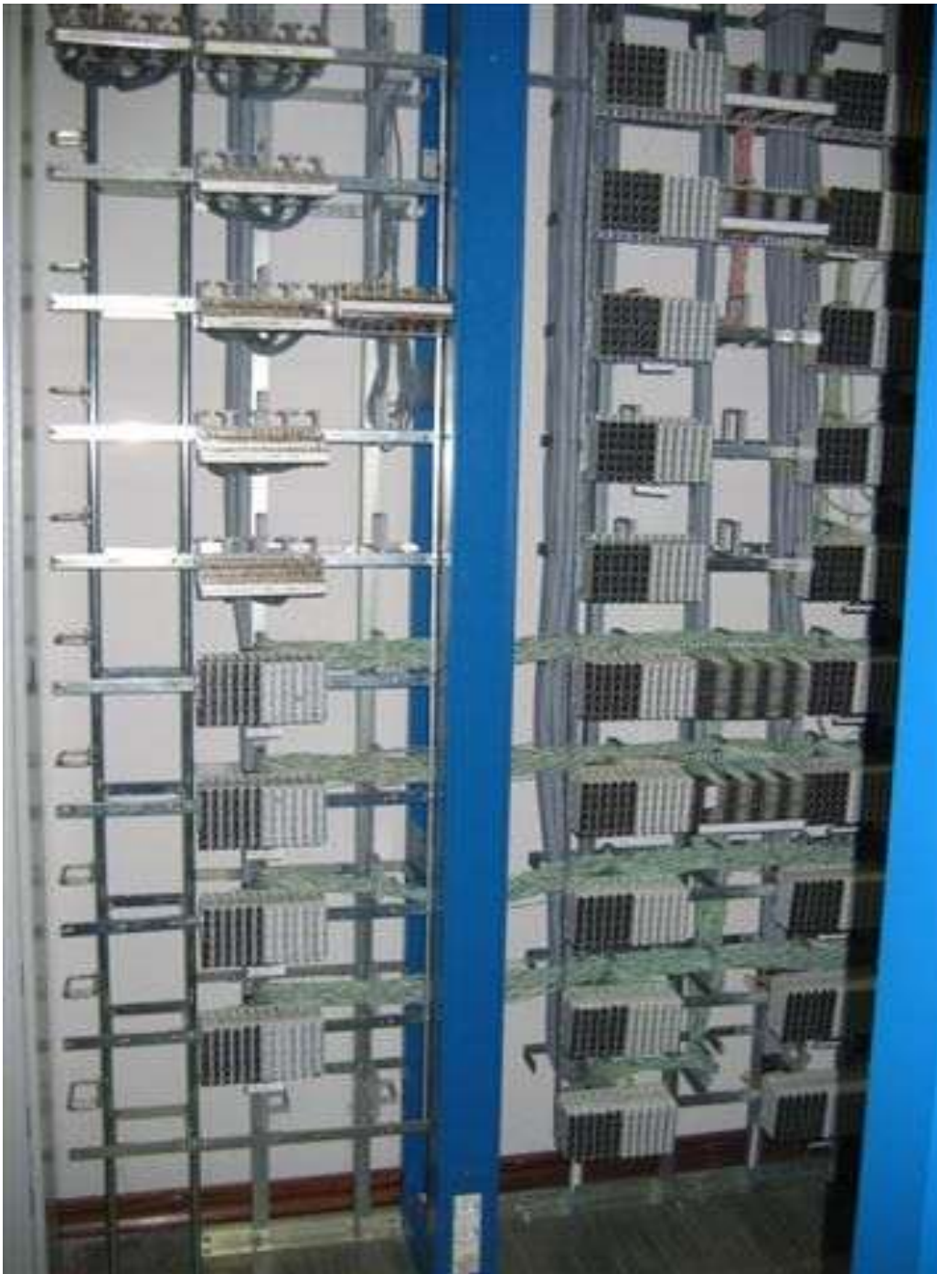
Figura 20 – Ripartitore elettrico monofronte 10 livelli
