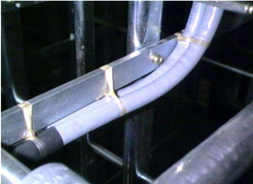
Figura 40 – Esempio di legatura dei cavi B.F. sul lato orizzontale del Ripartitore Doppio Fronte in prossimità della striscia di terminazione
