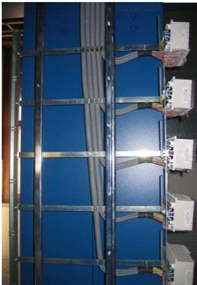
Figura 35 – Discesa cavi su Ripartitore doppio fronte
