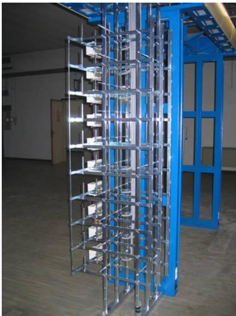
Figura 19 Ripartitore elettrico doppio fronte 10 livelli
