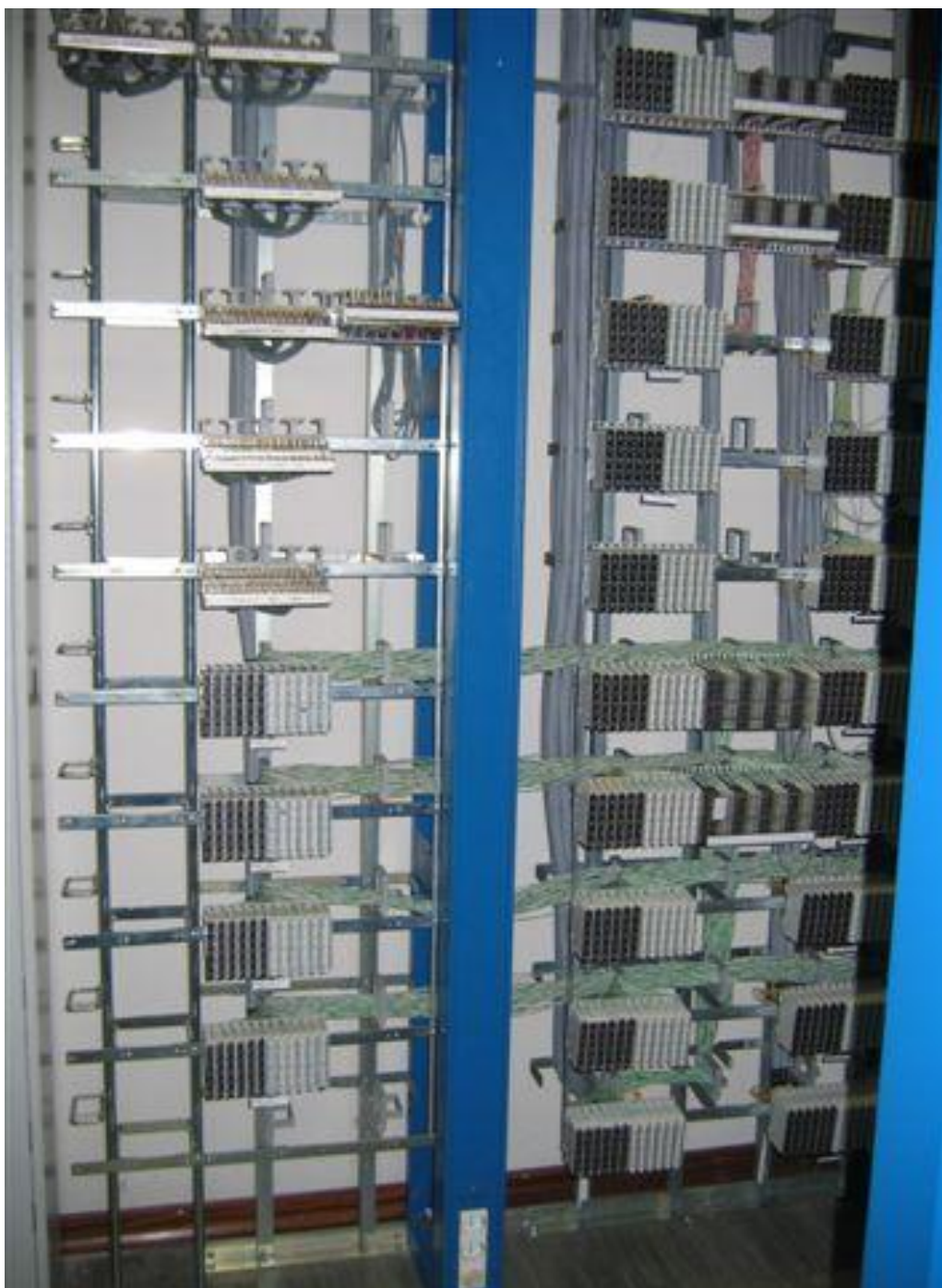
Figura 20 Ripartitore elettrico monofronte 10 livelli
