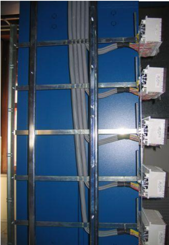
Figura 35 Discesa cavi su Ripartitore Doppio fronte.
