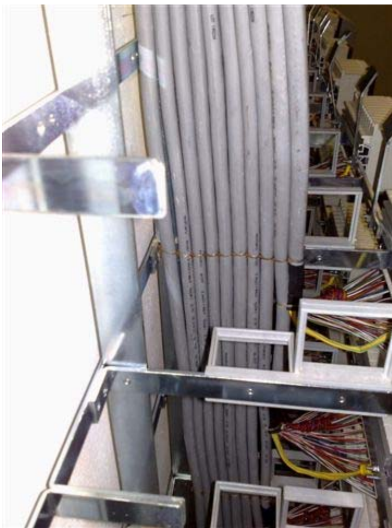
Figura 37 Esempio di posa su Ripartitore monofronte con un unico strato di cavi per tutti i livelli
