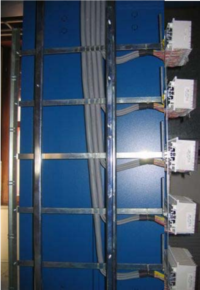
Figura 35 Discesa cavi su Ripartitore Doppio fronte.
