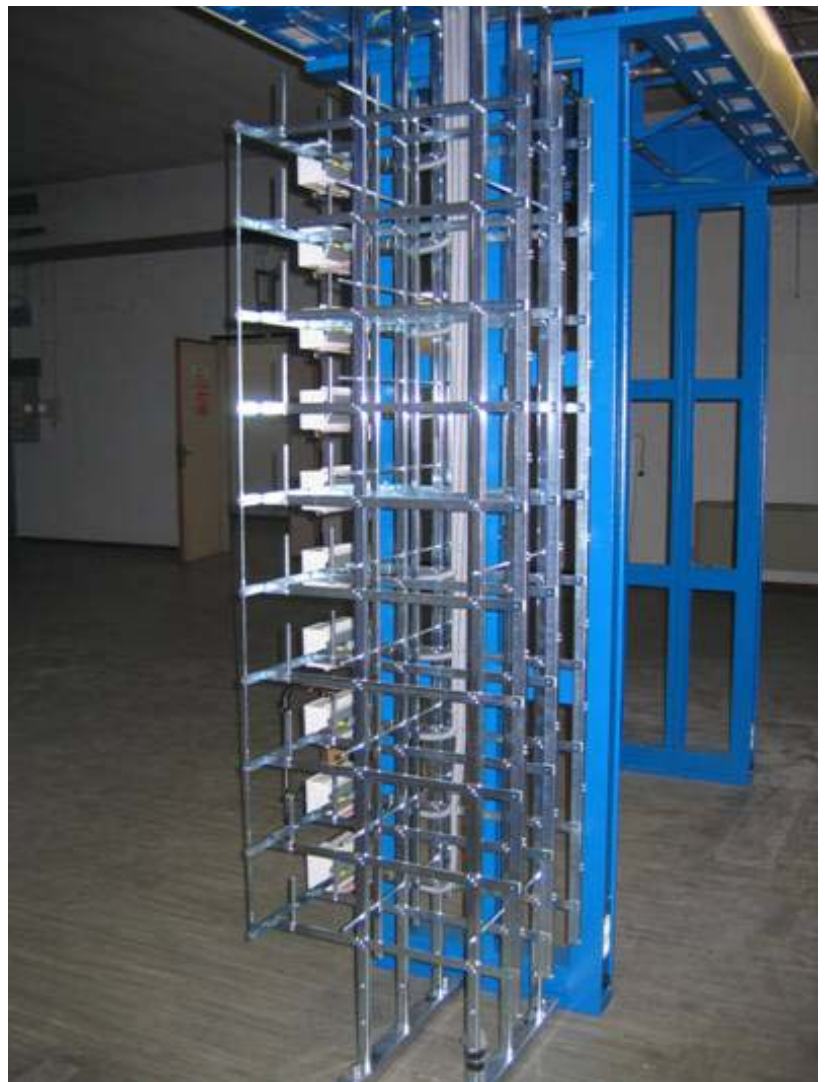
Figura 19 Ripartitore elettrico doppio fronte 10 livelli
