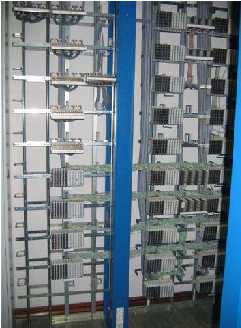
Figura 20 Ripartitore elettrico monofronte 10 livelli
