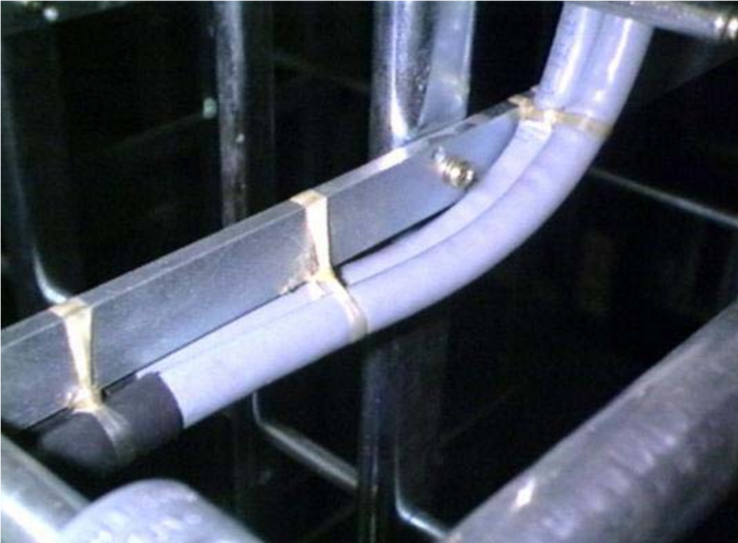
Figura 40 – Esempio di legatura dei cavi B.F. sul lato orizzontale del Ripartitore in prossimità della striscia di terminazione.
